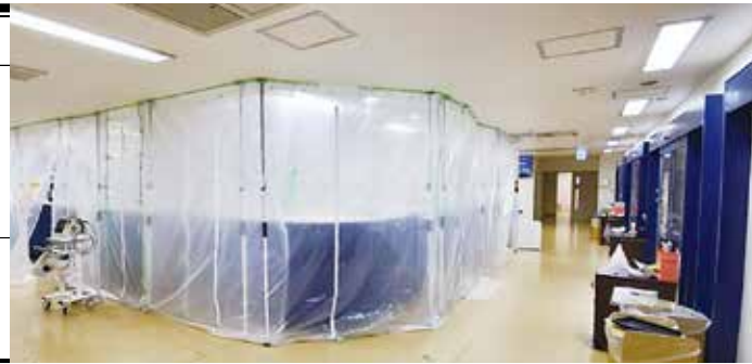
ナースセンターを陽圧化(グリーンゾーン確保)
